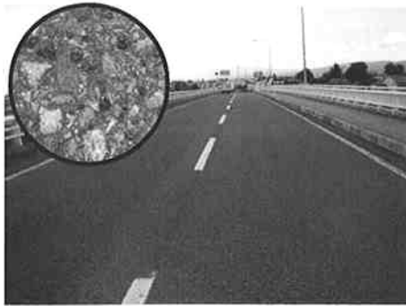
写真-1 ルビット舗装の供用状況 (交通量区分 N, 供用後14年経過時)
