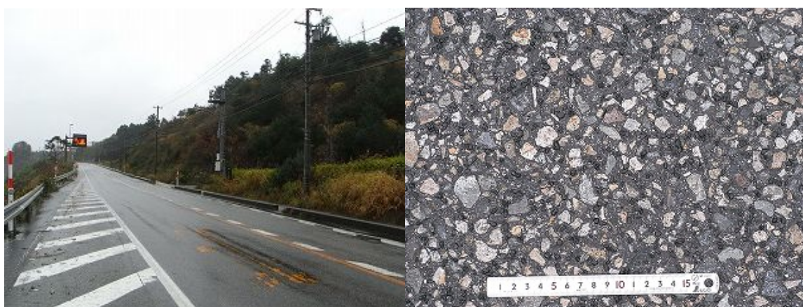
写真-3 ルビット舗装の供用状況（北陸地方の国道，交通量区分 N 5 ，供用後 7 年経過時）
