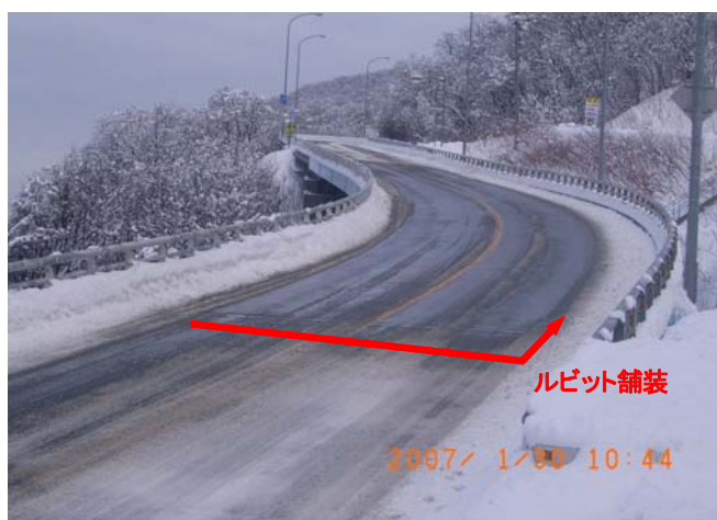
写真-4 供用後 14 年経過したルビット舗装の凍結抑制効果（北海道の国道）
