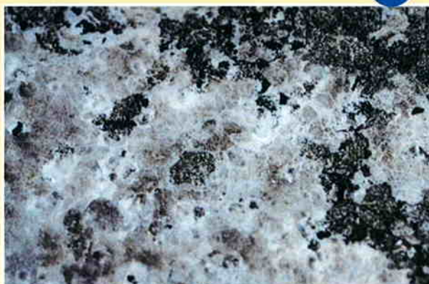
(3)クラックの発生と路面の露出状況
