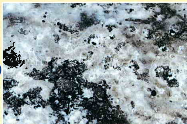
(4)路面露出の広がり状況
